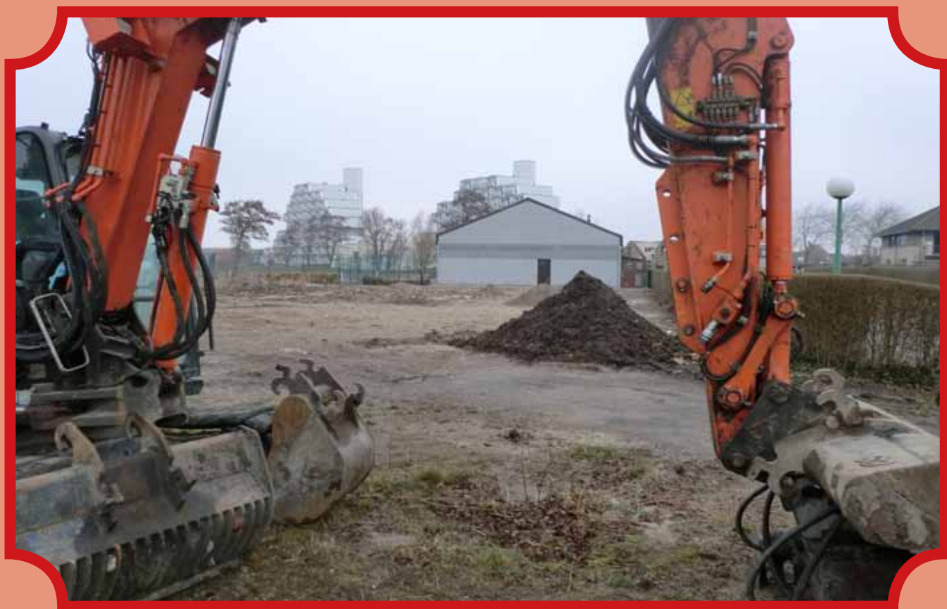
Werken funderingen eerste zwembad (Spa) / Travaux aux fondations de la première piscine.
